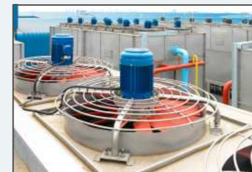
Вентиляторы и насосы
